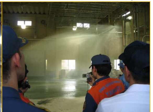
放水型スプリンクラー
